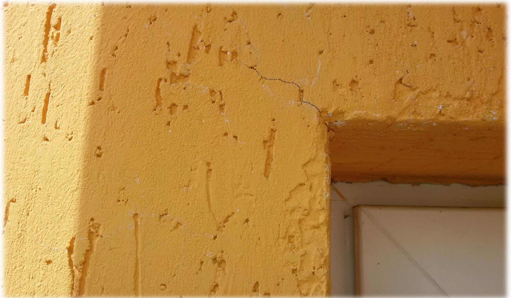
Діагональні тріщини у віконних і дверних прорізах
